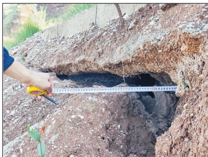
c 滑坡后壁张拉裂缝
