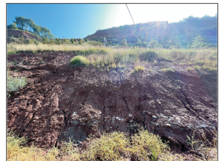
e 坡脚垂向裂隙发育
